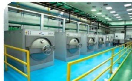
脱脂（バインダー除去）設備
